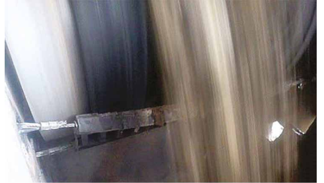
Bantta birkaç belirgin iz dışında geri taşımayı gösteren toz ve ince malzemeden temizlenmiş bant. Telif Hakkı © Martin Engineering 2023 Cleaning the belt of dust and fines with few telltale streaks on the belt denoting geri taşıma. Copyright © Martin Engineering 2023
